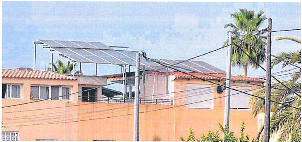
Placas solares en el tejado de un edificio situado en la pedanía murciana de Aljucer. GUILLERMO CARRIÓN / AGF
