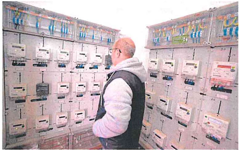
Contadores eléctricos en un bloque de pisos de la capital murciana. NACHO GARCÍA / AGF
