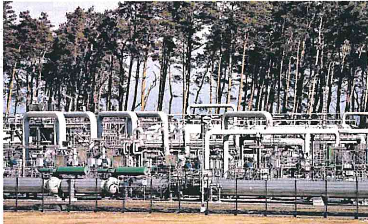
Gasoducto Nord Stream en Lubmin (Alemania).
