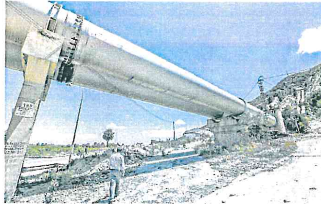
Canalización del acueducto que llega hasta el embalse de La Pedrera.
