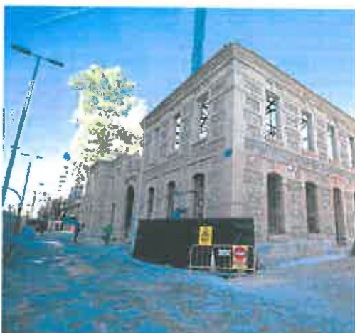
Trabajos de rehabilitación de la cárcel, en febrero de 2021. J. CARRIÓN / AGN
