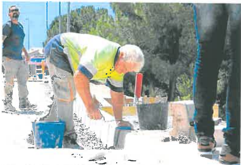
Un operario da los últimos toques a la acera repuesta en la urbanización Torre Guil. AYTO. MURCIA
