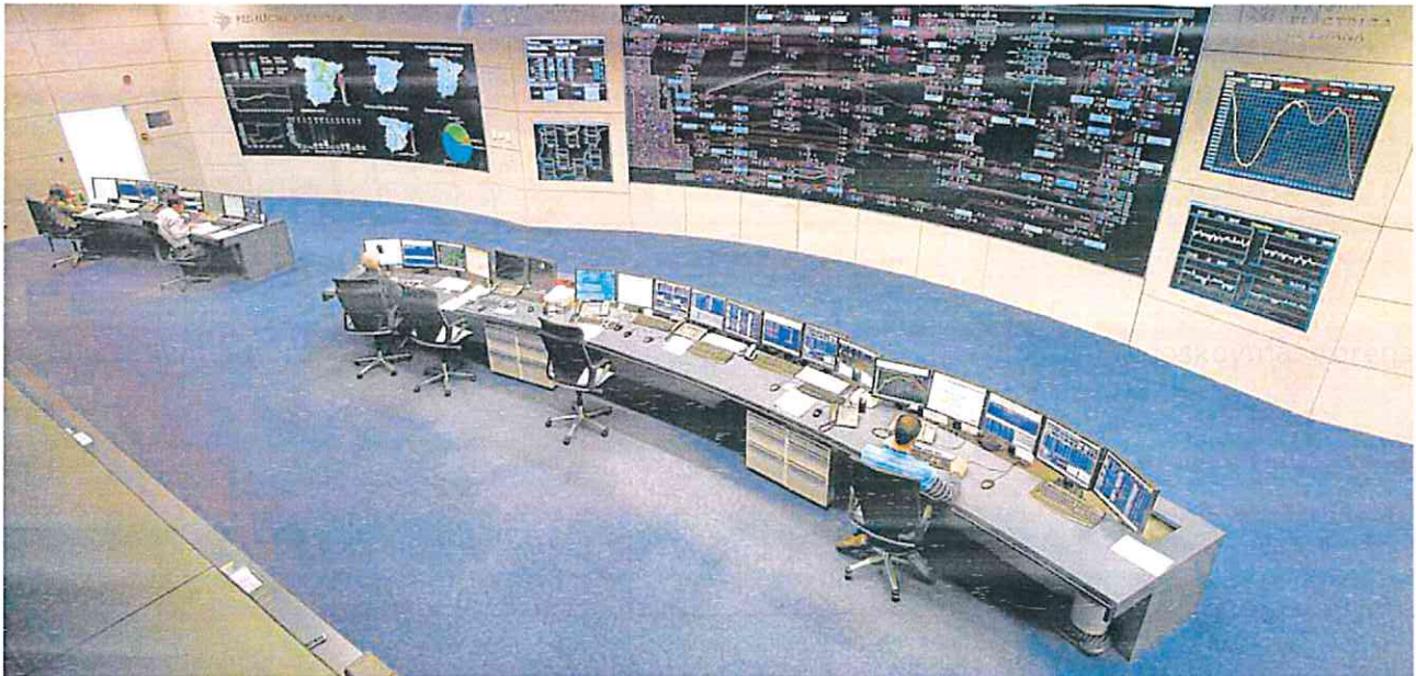
Sala de control de Red Eléctrica de España (REE), desde donde se supervisa el abastecimiento a todo el país. JOSÉ RAMÓN LADRA
