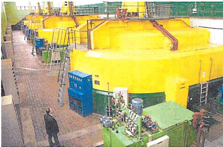
Sala de turbinas de la central hidroeléctrica de Flix, en Tarragona. JAUME SELLART / EFE
