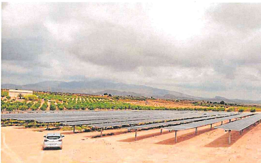
Una de las dos plantas fotovoltaicas de Comunidad Solar en Fuente Álamo. cs
