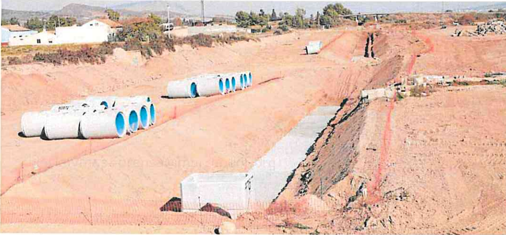
Aspecto de las obras de construcción de la línea de alta velocidad entre Murcia y Almería, a la altura de Totana, el jueves. JAIME INSA / AGM
