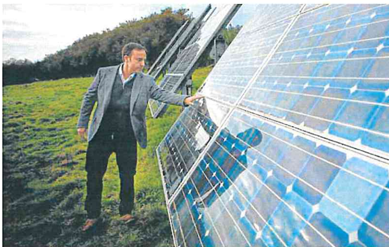
Paneles fotovoltaicos de una minicentral solar. IMANOL RIMADA
