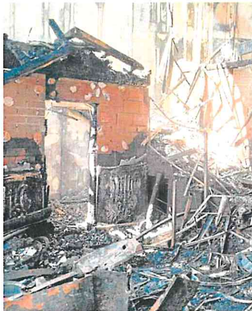
Estado en que quedó la zona calcinada. BOMBEROS MURCIA
