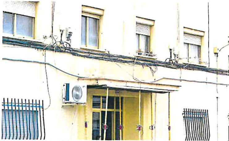
Casa cuartel de la Guardia Civil de Cartagena, en ruinas.
