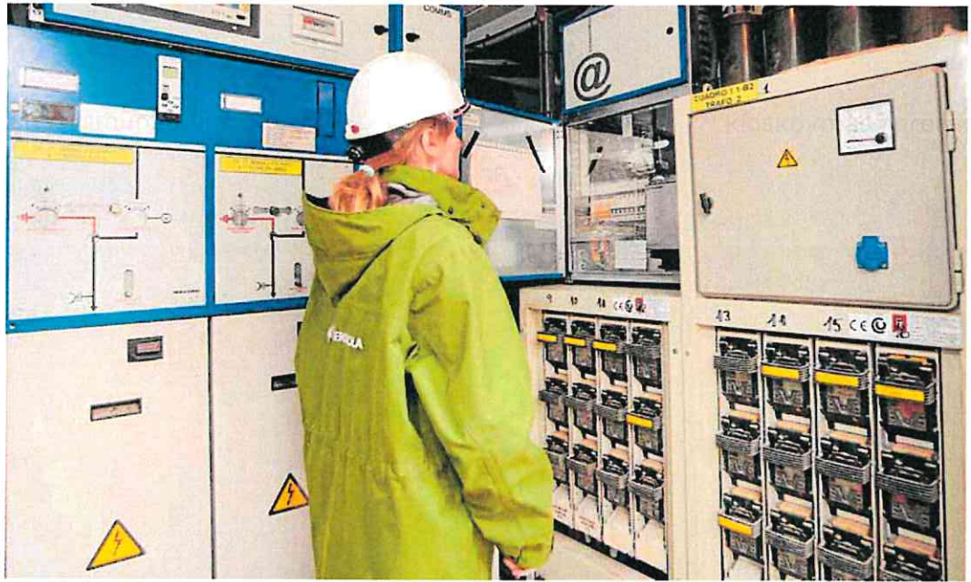
Una empleada de Iberdrola examina la sala de contadores de un bloque de pisos. LV
