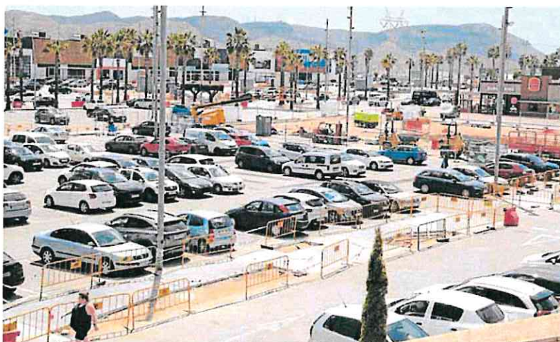
Aparcamiento del centro comercial y de ocio de Parque Mediterráneo, donde albañiles y máquinas habilitan zonas verdes y de juegos y reordenan los estacionamientos. ANTONIO GIL / AGM
