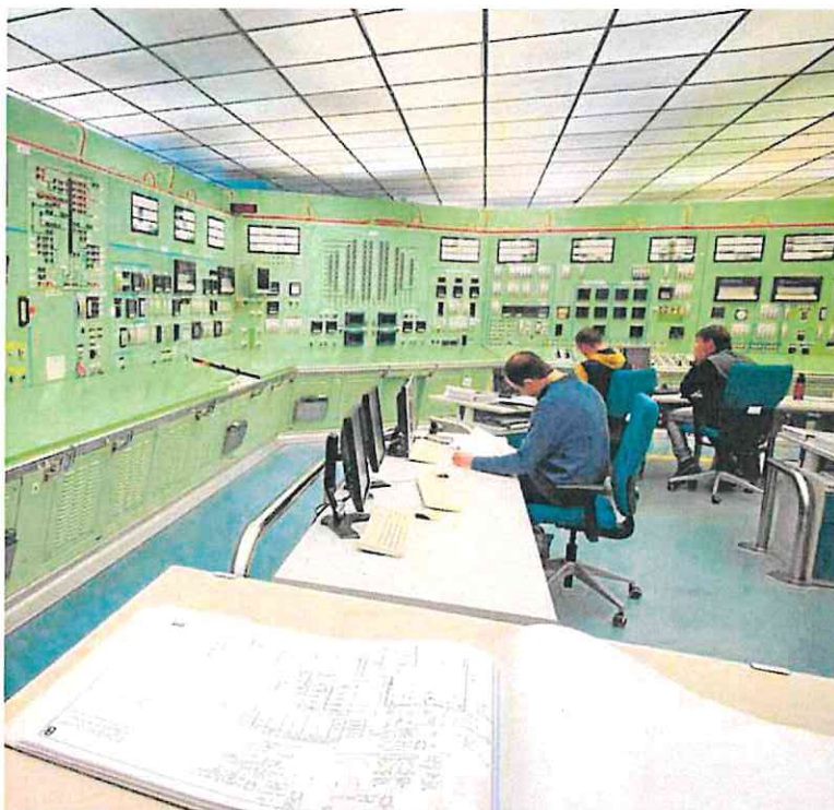
Sala de control de la central nuclear de Garoña (Burgos), ya en proceso de desmantelamiento. E. P.
