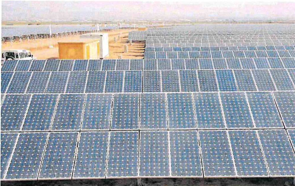
Paneles de una planta solar en Fuente Álamo.
