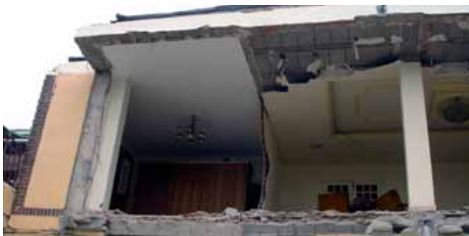
Fachada de uno de los edificios más afectados
