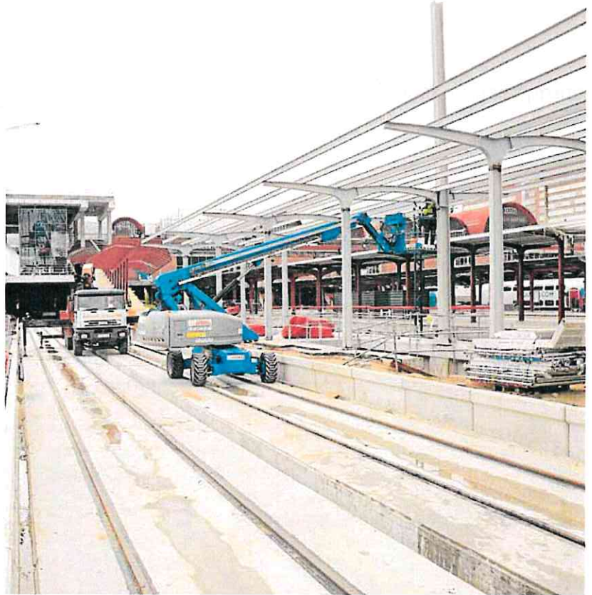
Obras de ampliación de la playa de vías para la alta velocidad en la estación de Madrid-Chamartín. Adif
