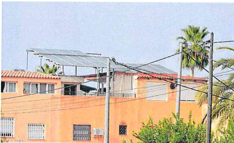
Placas solares fotovoltaicas para autoconsumo instaladas sobre viviendas particulares. GUILLERMO CARRIÓN / AGM
