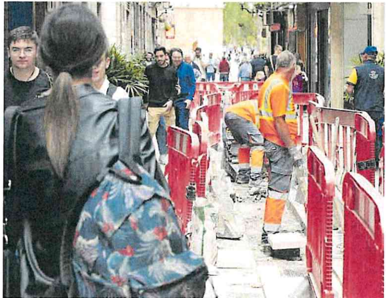
Operarios de una empresa de la construcción trabajan en la calle Trapería de Murcia.
